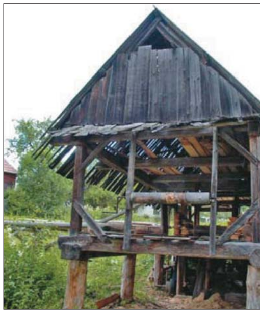
Vasláb-beveder 2003, nagyon rossz állapotú tetőszerkezet
