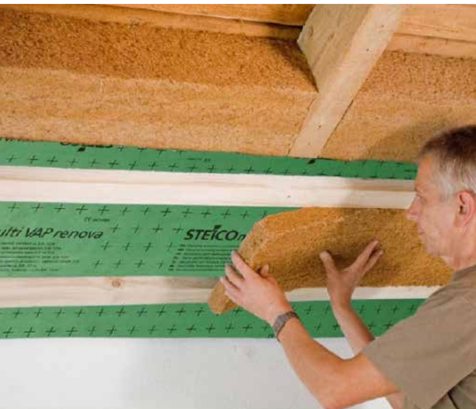
3. ábra A farostalapú szigetelés egy jól bejáratott termék, mely az épületekbe beépítve hosszú távon tárolja a szén (Forrás: CEI-Bois – EOS 2024a)
