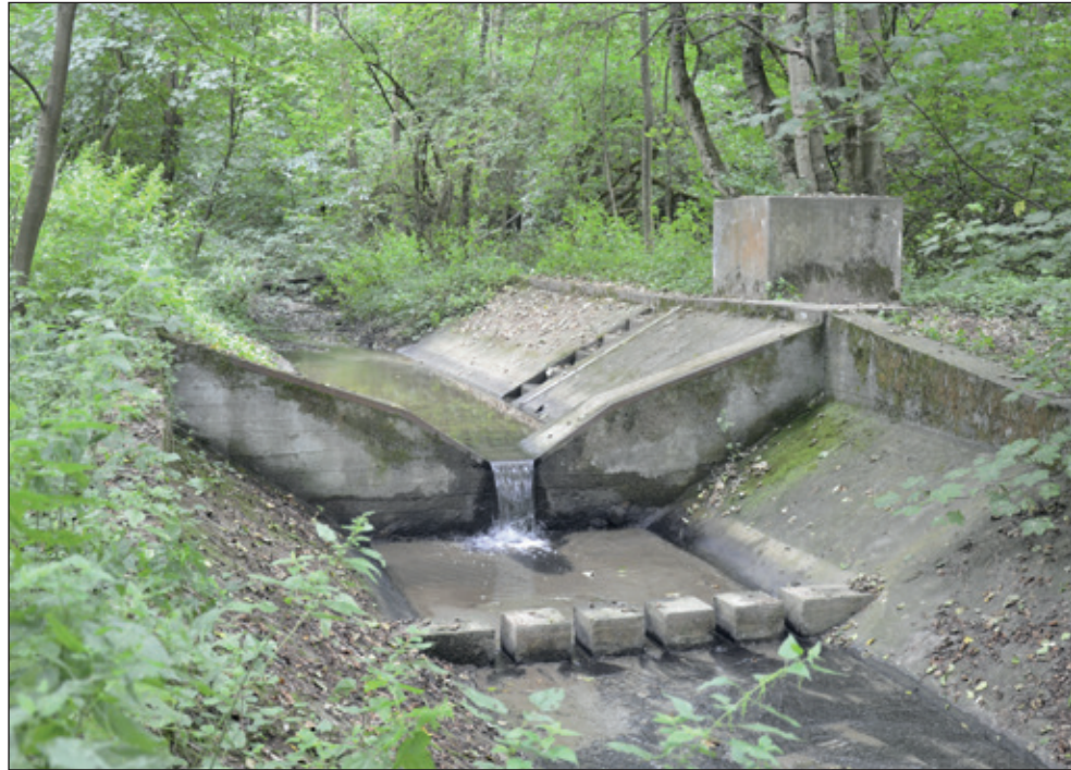
Vízhozammérő műtárgy a Rák-patakon
