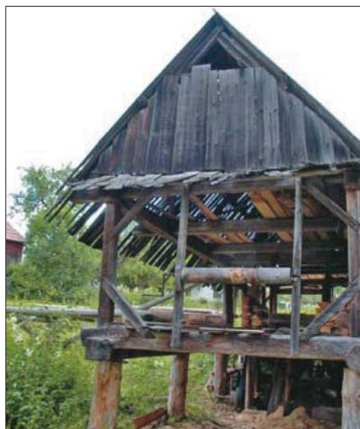
Vasláb-beveder 2003, nagyon rossz állapotú tetőszerkezet
